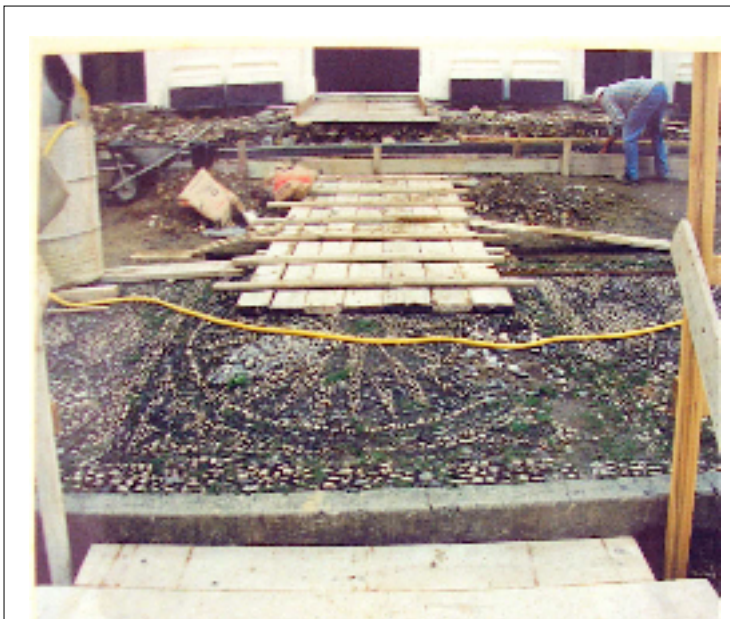
fig. 2 - il rosone del sagrato deteriorato e coperto di muschi durante la fase di demolizione
